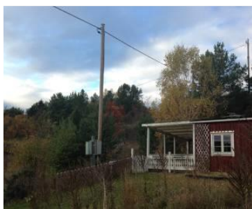
Lågspänningsledning i luft inom Dal 5:183
