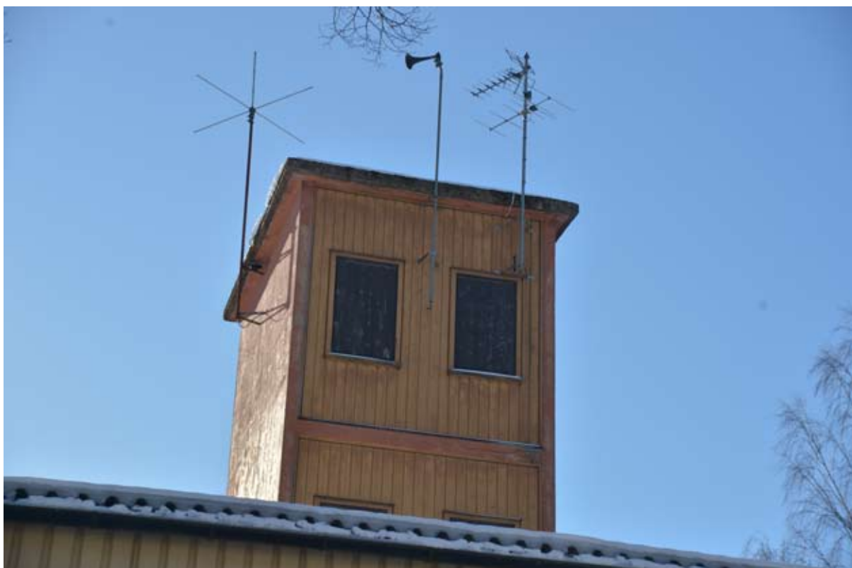
Slangtornets norra fasad. Tornet har omfattande skador i stommen pga karbonatiserande betong vilket har resulterat i armeringskorrosion.
