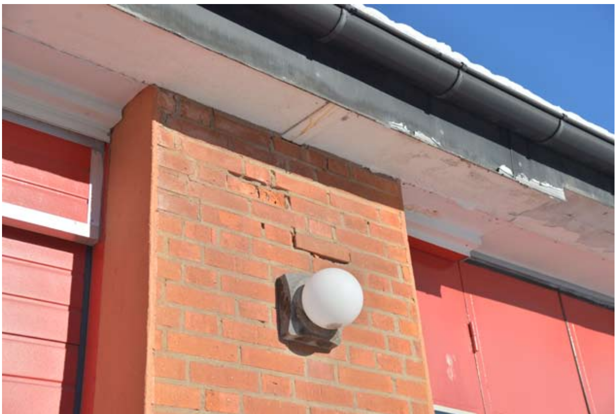
Detalj av den äldre vagnhallen med sekundära portar, ändrade överliggare och en tegelpelare som ger intryck av att ha smalats av. Fasadteglet har frostsador.
