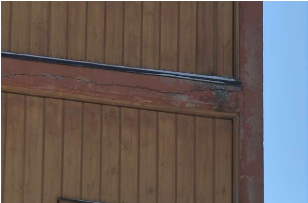
Detalj av slangtornets stomme med skador.
