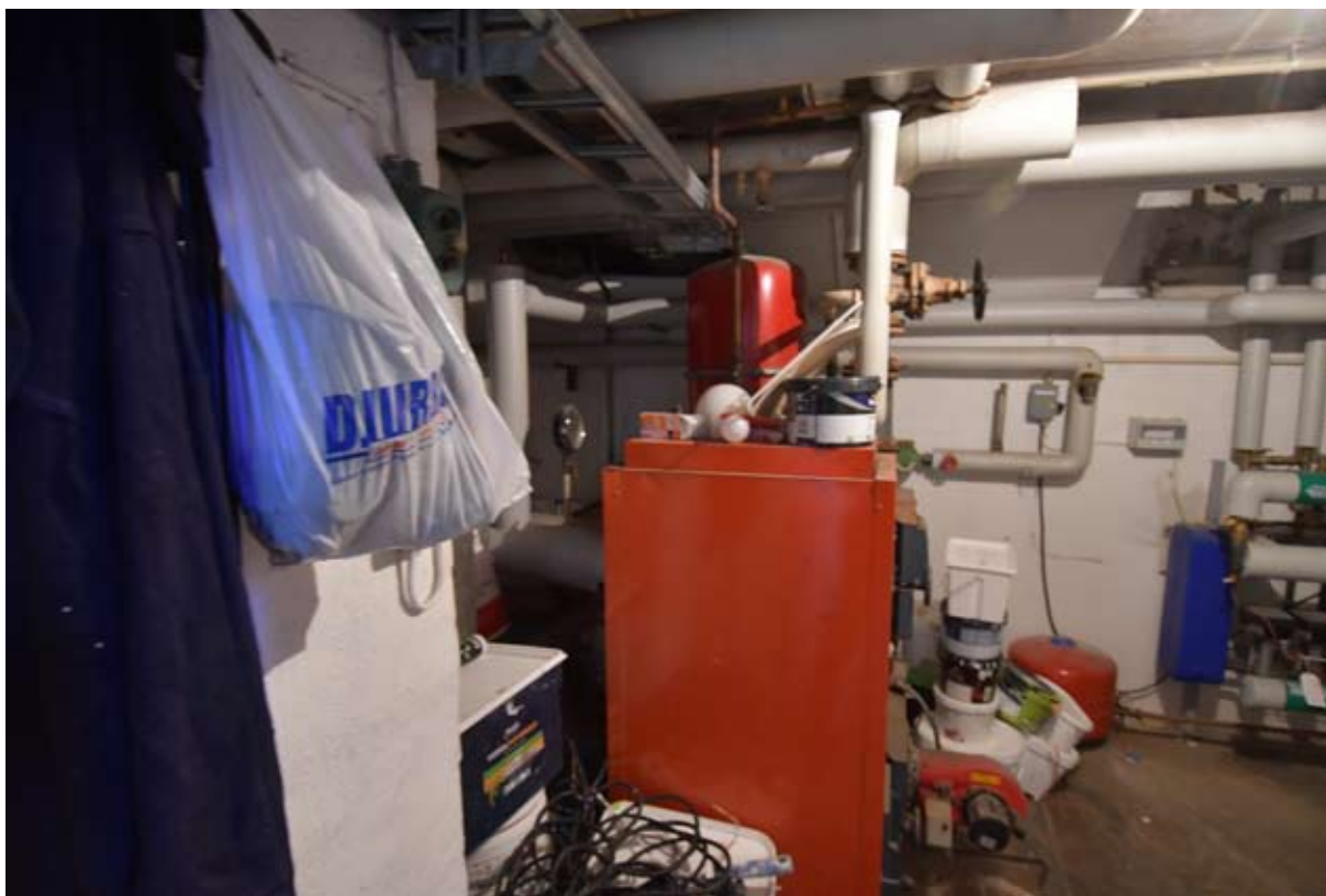
Pannrum i källaren med sekundära installationer av sent datum.
